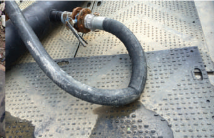
Fugas en la manguera
