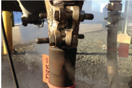
Roturas o grietas en la manguera
